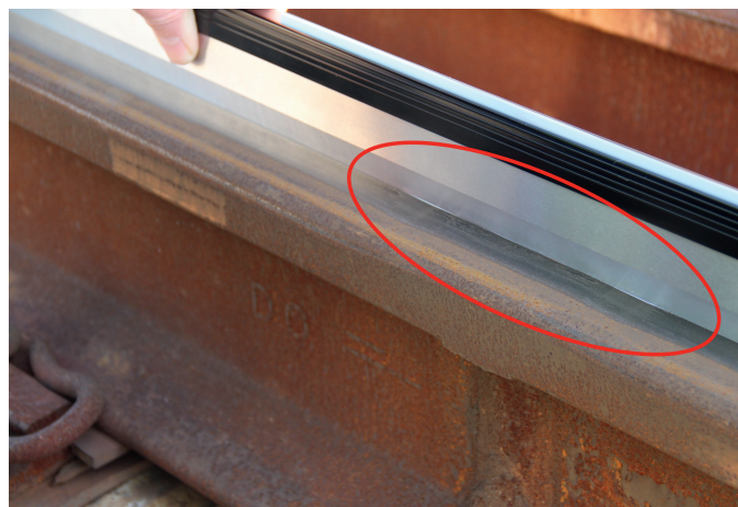
Abb. 4: Durch Verschleiß bedingte Dellen in der Weichglühzone einer aluminothermischen Schweißung.
