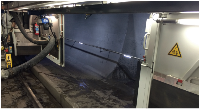
Abb. 3: Die geöffnete Seitenwand des mobilen Instandhaltungssystems ermöglicht den geschützten Zugang für die Reinigung von Drainage-Kanälen im Tunnel.
