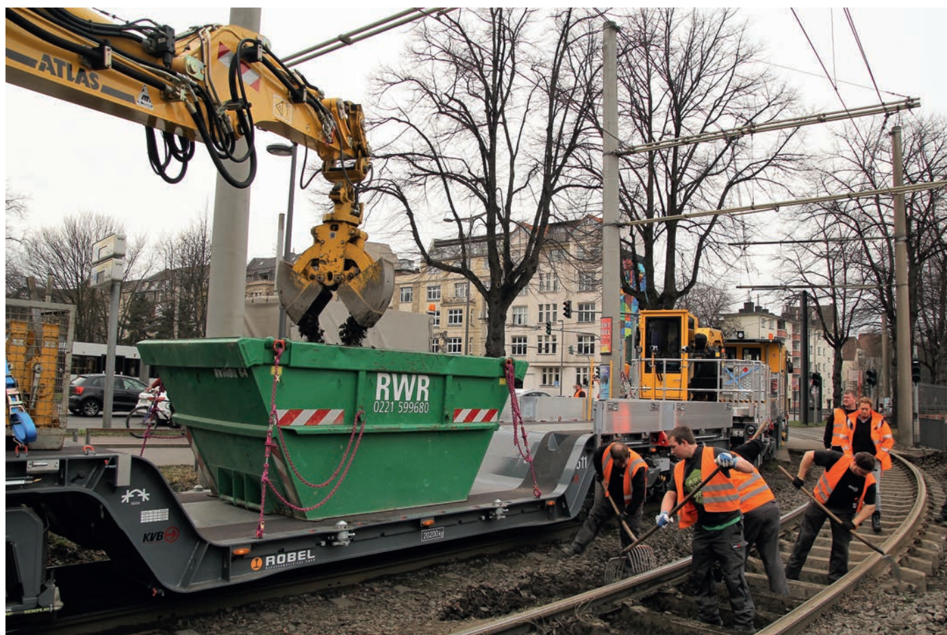
Abb. 3: Einsatz des Transportsystems – hier mit Niederflrwagen – für laufende Instandhaltungsarbeiten im Stadtgebiet Foto: Stephan Anemüller, KVB
